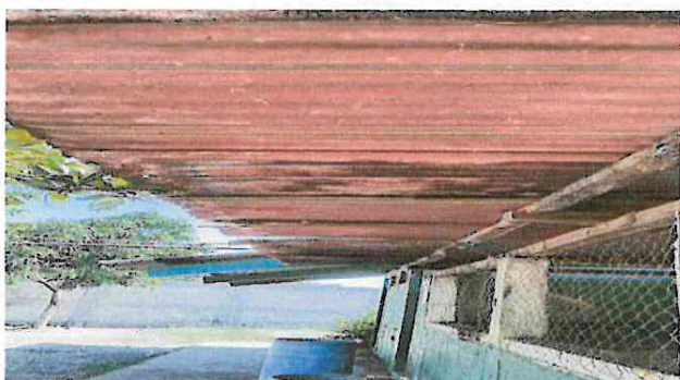
Foto 1: Techo de cocina en mal estado
