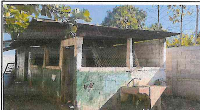
cambio de grifos en mal estado
