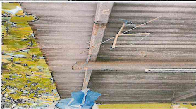
Foto 2: Estructura metalica y laminas en mal estado
