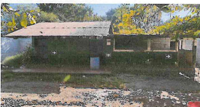
Foto 6: Lamina sanitarios podrida ya de vieja
